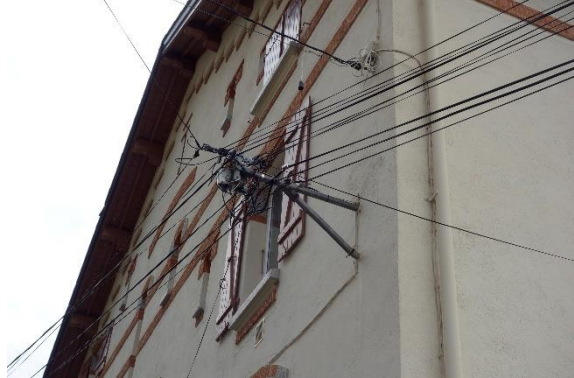
Elektrický rozvod ve Fontepedrose
